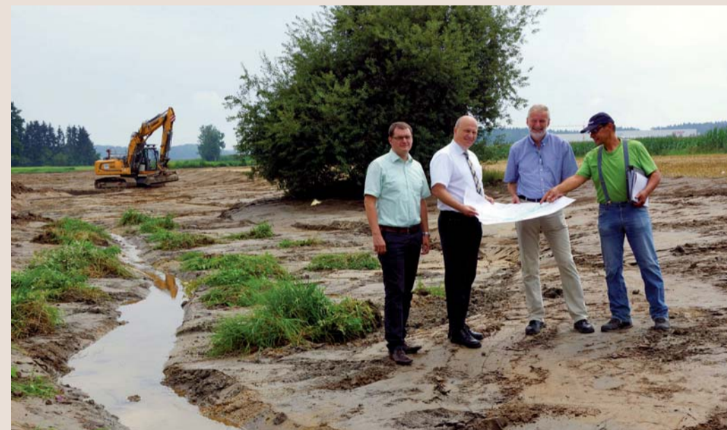
Am südlichen Ortsrand von Schierling wurde der Allersdorfer Bach in eine „Natur-Erlebnisfläche!“ umgestaltet. V.l. Rathaus-Geschäftsleiter Manuel Kammermeier, Bürgermeister Christian Kiendl, Dipl.-Ingenieur Josef Sedlmeier, Bauleiter Georg Maierhofer
