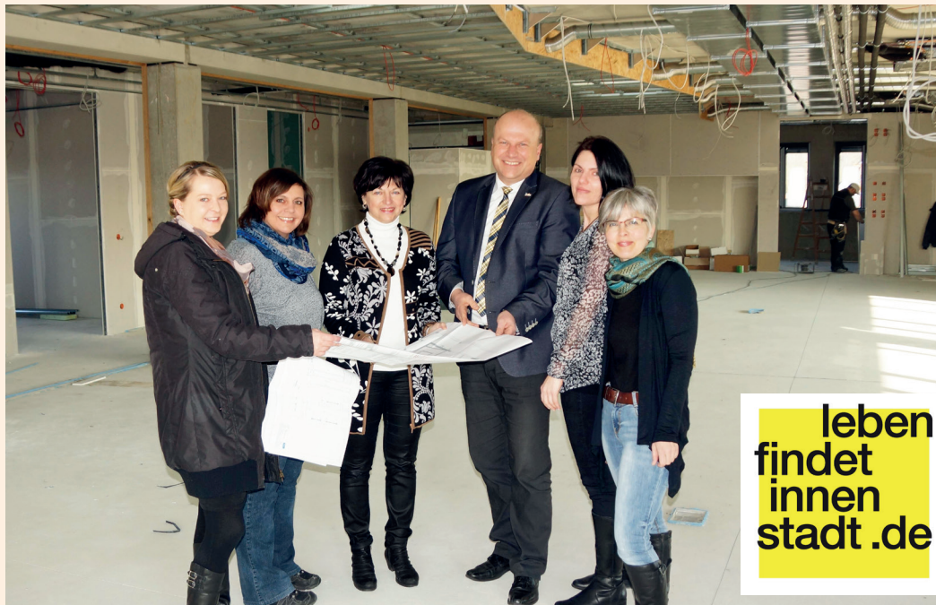
■ Noch sind Bücherei und Familienstützpunkt im Rohbau. Es besichtigten v.l. Architektin Nina Kellner von der Bauabteilung im Rathaus, Caroline Gascher, Christa Blüml, Silvia Schober und Helga Heindl zusammen mit Bürgermeister Christian Kiendl
